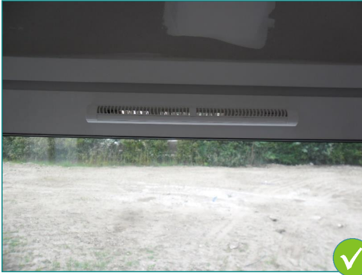
1 : Entrée d'air en bon état
