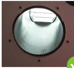
5 : la mortaise présente une section égale ou supérieure à la section libre de l'entrée d'air (cas d'une entrée d'air en traversée de mur circulaire)
