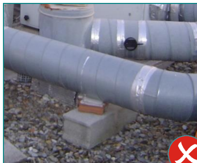
3 : Conduit rigide horizontal avec support NON adapté
