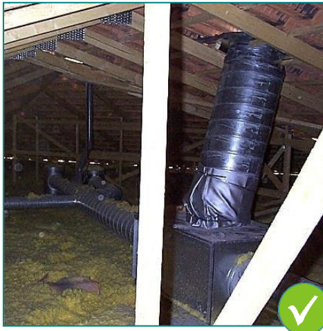
1 : Rejet correctement raccordé sur l'extérieur
