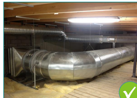
4 : Installation en conduits rigides correctement réalisée
