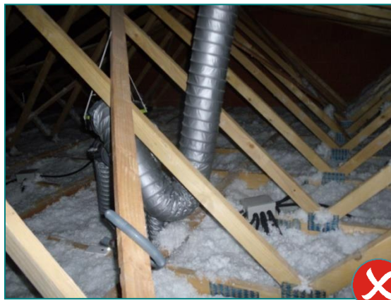
2 : Mauvaise mise en œuvre de conduits souples en combles (coudes > 90°)
