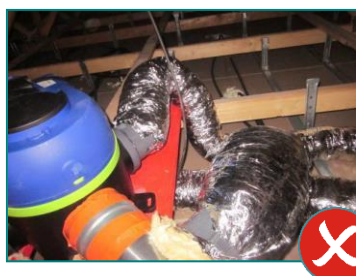
2 : Conduits souples présentant de trop nombreux coudes parfois supérieurs à 90°
