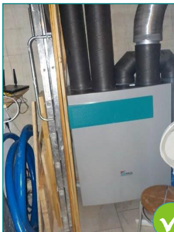
1 : Raccordements correctement réalisés sans défaut d'étanchéité visible
