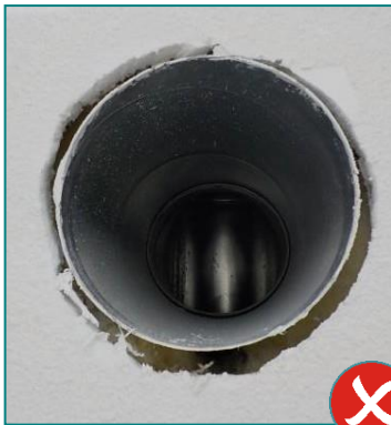
2 : Absence de dispositif de raccordement
