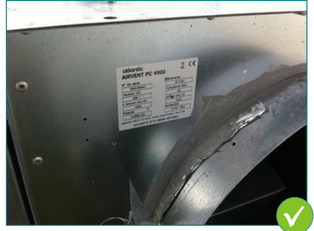
2 : Références lisibles sur une étiquette de caisson de ventilation d'un bâtiment de logements collectifs
