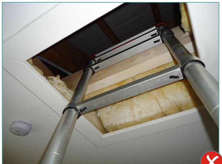
2 : Trappe d'accès encombrée et réduite
