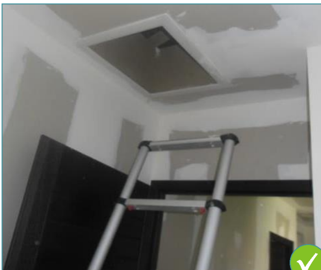
1 : Trappe d'accès correctement dimensionnée
