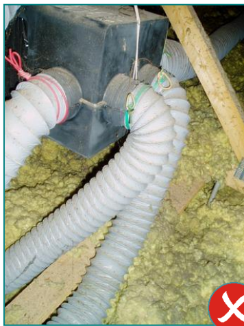
3 : Raccordements mal réalisés avec risque de débranchement
