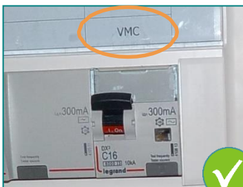
2 : Disjoncteur individuel et identifié pour la ventilation avec « VMC »
