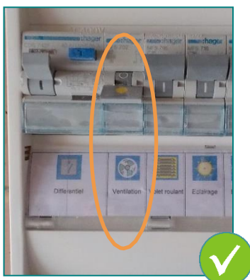
3 : Disjoncteur individuel et identifié pour la ventilation avec symbole + « ventilation »
