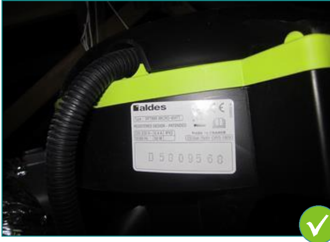
1 : Références lisibles sur une étiquette de caisson de ventilation d'une maison individuelle
