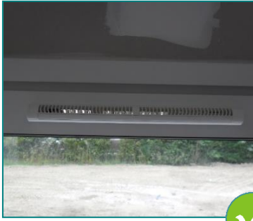
4 : Entrée d'air correctement mise en œuvre
