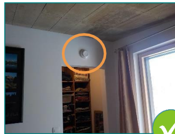
3 : Bouche de soufflage dans une chambre
