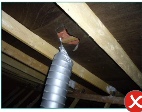
2 : Rejet NON raccordé sur l'extérieur (refoulement dans les combles)
