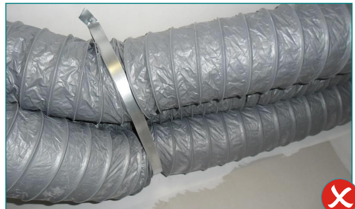
5 : Ecrasement des conduits souples par l'élément d'attache
