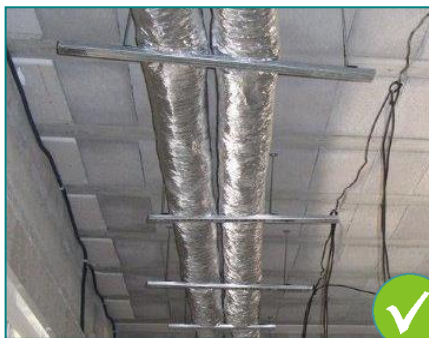
1 : Conduits souples correctement supportés
