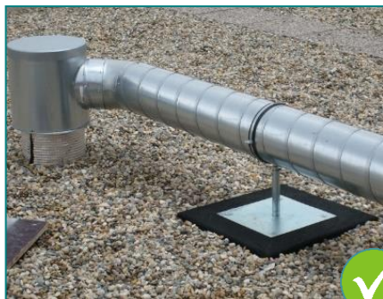
2 : Conduit rigide horizontal correctement supporté
